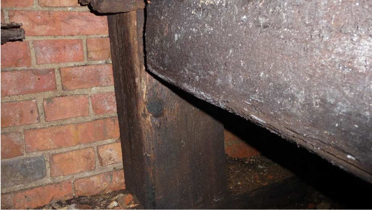
Abbildung 31: Blick in den süd-östlich freigelegten Hohlraum (siehe Pos. 2 Bild 29) mit Blick auf die Holzabstützung und Ziegelmauer (Blickrichtung NW-SO)
