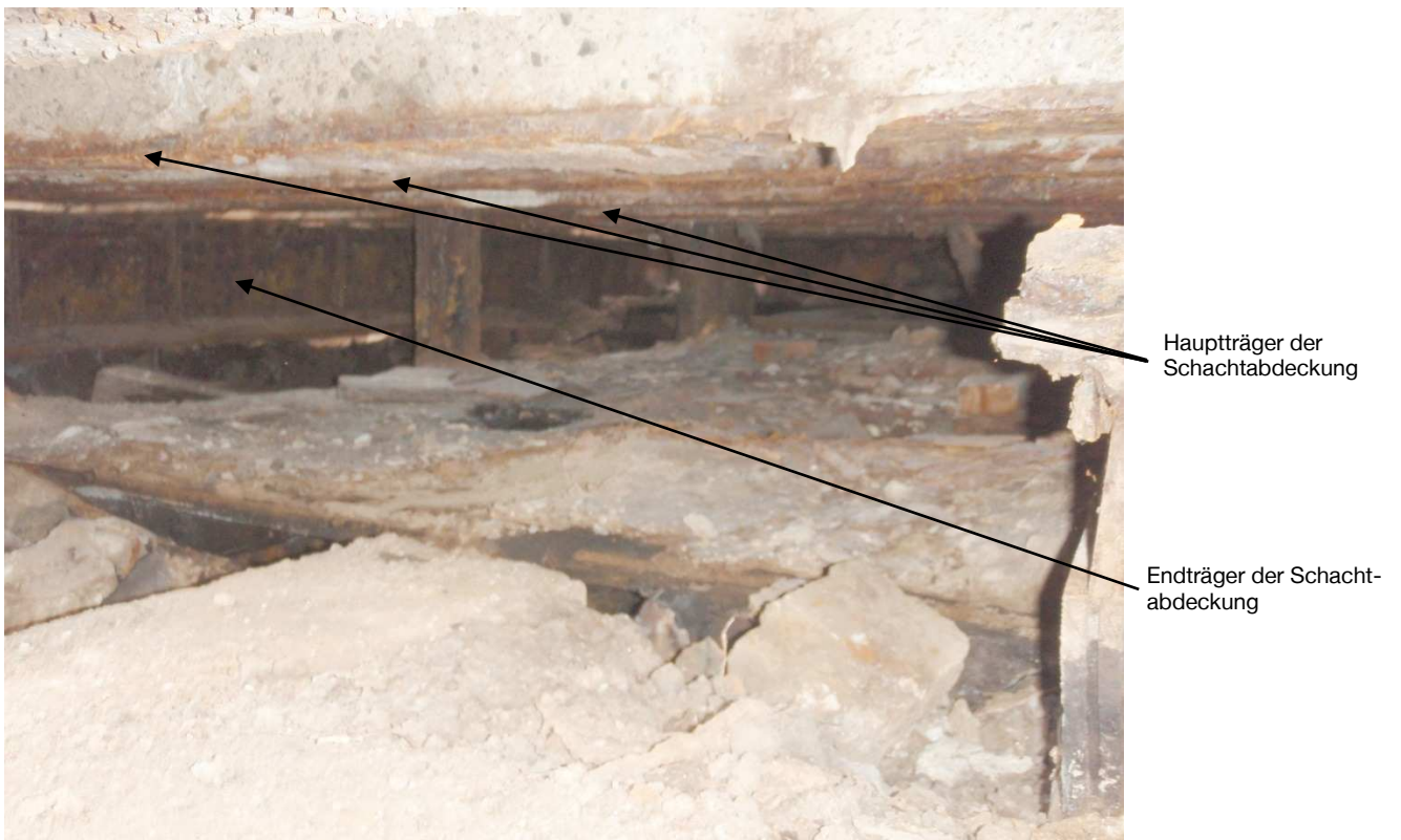
Abbildung 10: Blick unterhalb der Hauptträger der Schachtabdeckung im westlichen Bereich Schacht Asse 1 (Blickrichtung SW-NO)
