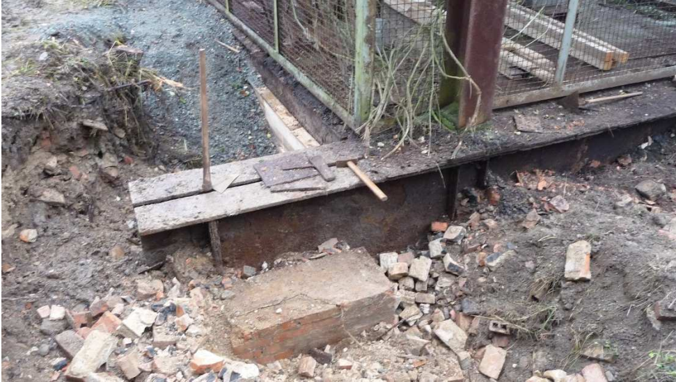
Abbildung 14: Blick auf die beiden Doppel-T-Endträger im südlichen Bereich von Schacht Asse 1 (Blickrichtung SW-NO)
