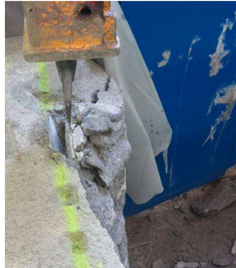
Abbildung 62: Mit Flachmeißel gelöstes Bruchstück aus dem Steinsalzbeton.
