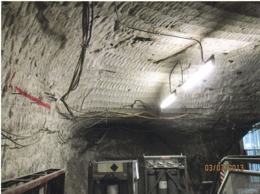
Bild 23: NW-Füllortbereich mit Abschalungen in der Firste und im Übergang Firste/Stoß
