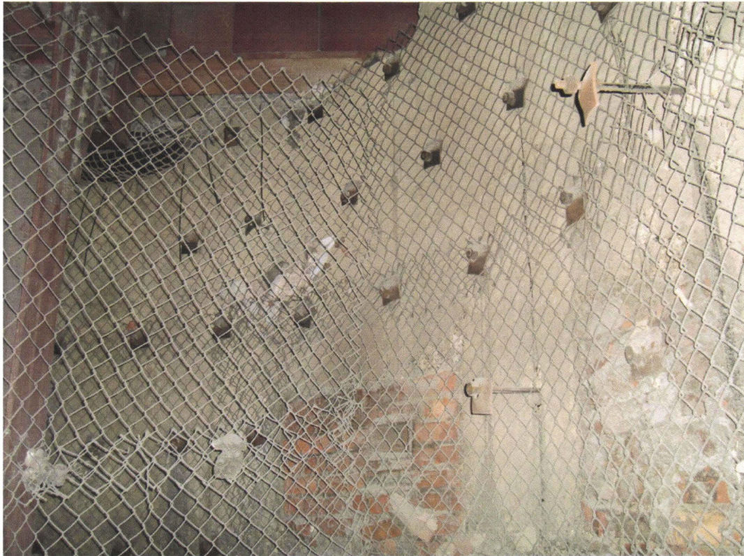
Bild 19: NE'-Schachtausbau, mit Maschendrahtverzug und teils defekter Ankerung
