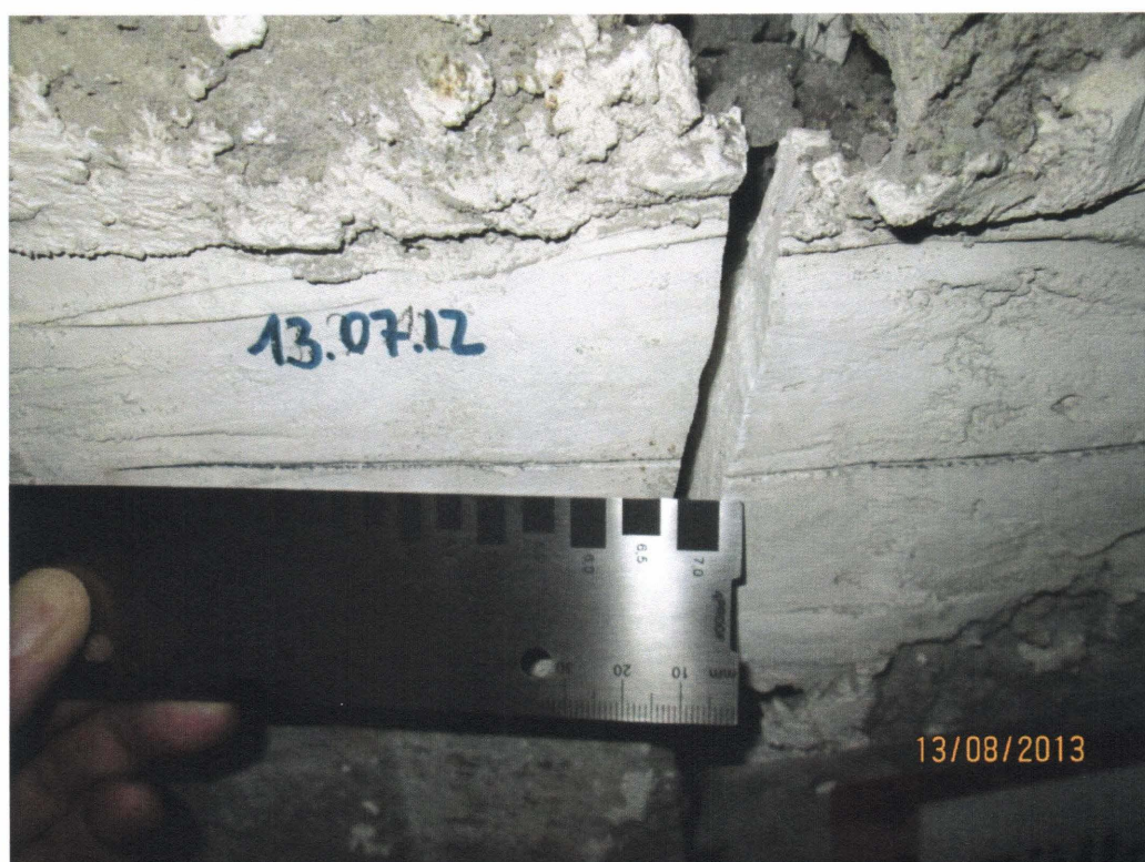
Bild 14: Riss an GM8 (Öffnungsweite ca. 7,0 mm, 13.08.2013), am SW'-Pfeiler (Spritzbeton)
