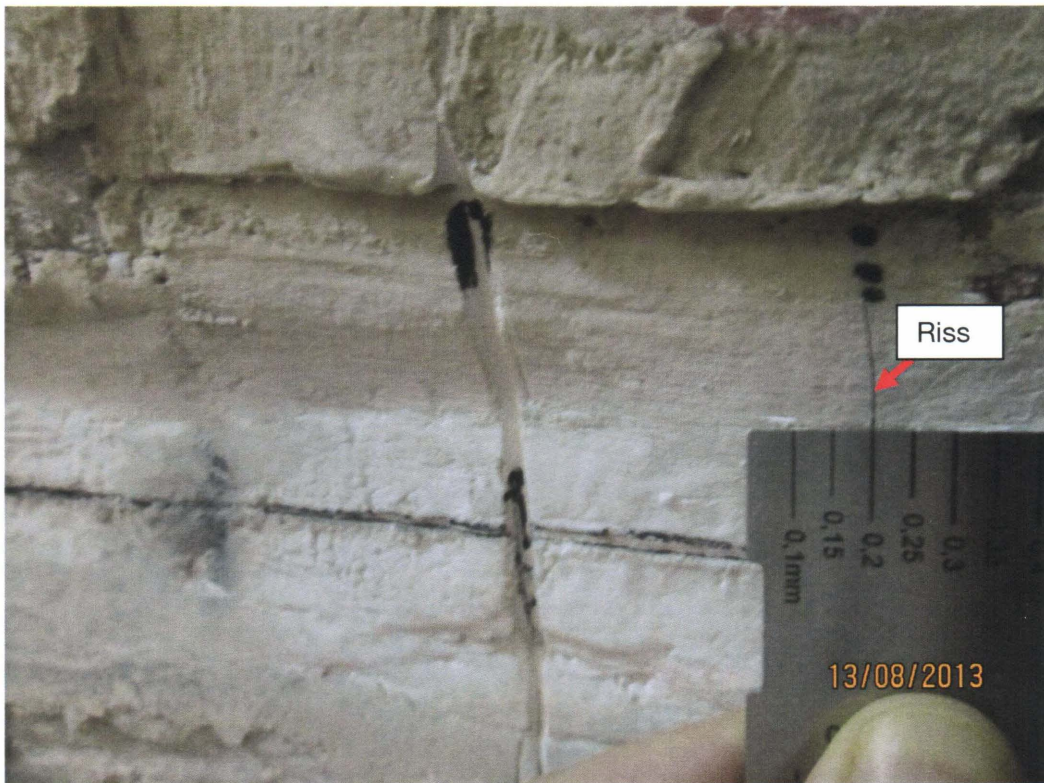
Bild 15: Riss mit Öffnungsweite von max. ca. 0,2 mm in GM4 im Stoß am SE' Füllortrand
