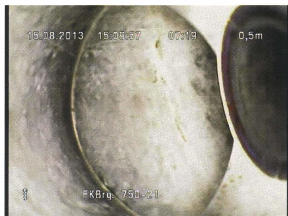
Bild 8: Riss mit ca. 2 mm Öffnungsweite (FKBrg. 750-21 – Position ca. 0,50 m)
