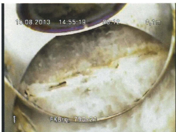
Bild 5: Riss mit ca. 2-4 mm Öffnungsweite (FKBrG.750-21-Position ca. 0,05 m)
