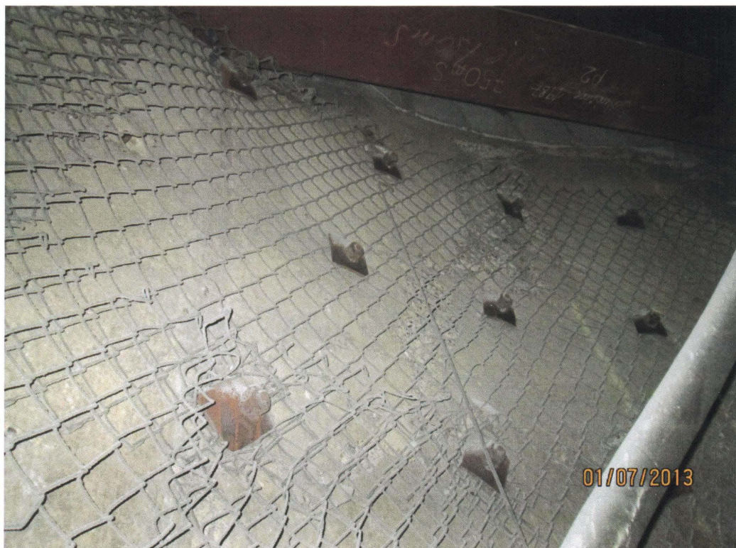
Bild 18: Auflagesituation am durch Gebirgsdruck geschädigten Betonausbau, SE-Ecke Schacht 2
