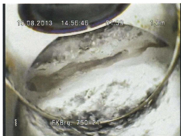
Bild 12: Riss mit ca. 10 mm Öffnungsweite (FKBrg. 750-21 – Position ca. 1,23 m)
