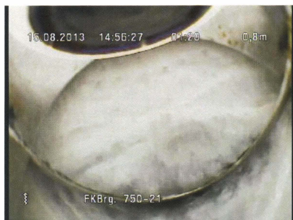
Bild 10: Riss mit ca. 1-2 mm Öffnungsweite (FKBrg. 750-21 – Position ca. 0,81 m)
