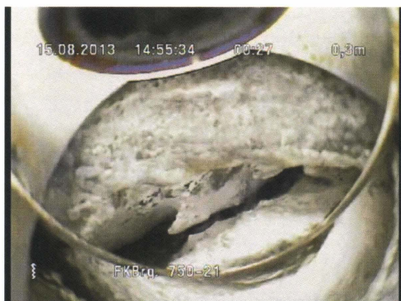
Bild 7: Riss mit ca. 7 mm Öffnungsweite (FKBrg. 750-21 – Position ca. 0,30 m)
