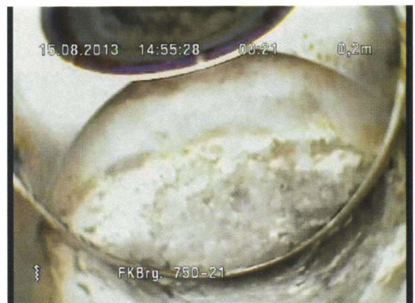
Bild 6: Riss mit ca. 2 mm Öffnungsweite (FKBrG. 750-21 - Position ca. 0,19 m)
