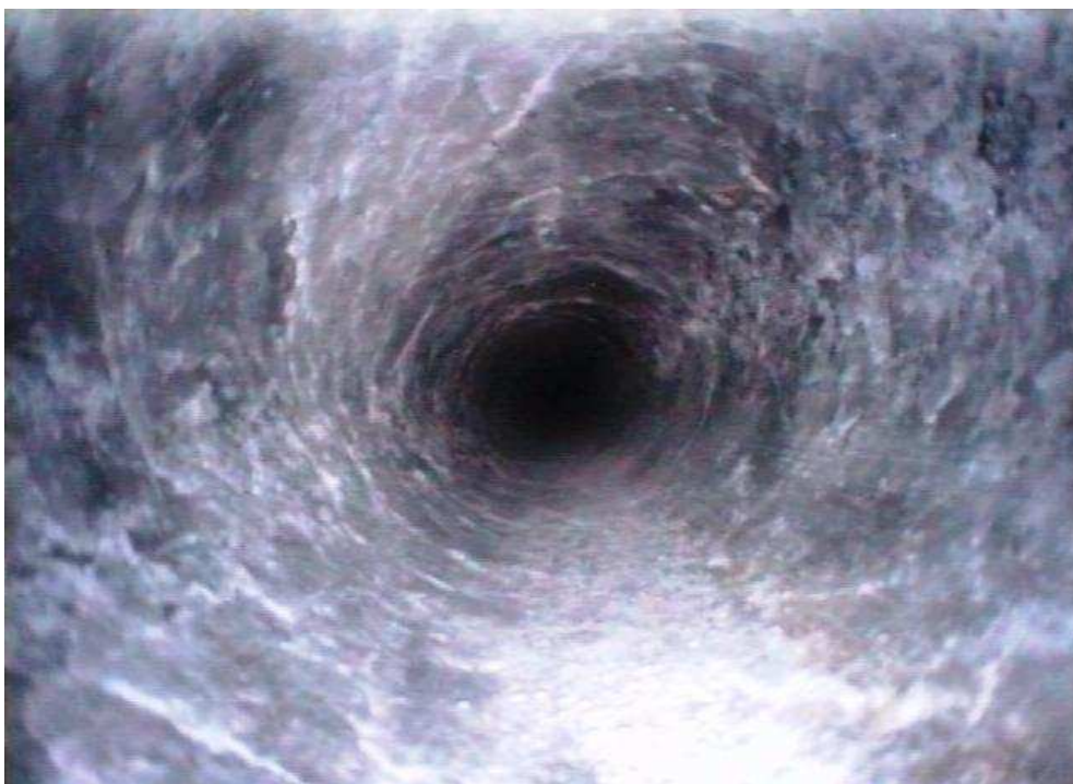
Foto 1b: Bohrloch bei 41 m, elliptisch beansprucht, kleine Ausbrüche
