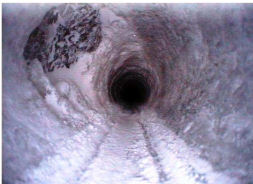
Foto 5b: Ausbruch östliche Bohrlochwand bei 25,0 m
