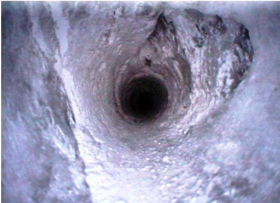
Foto 6c: Ausbruch/Riss im Westen bei 26,55 m
