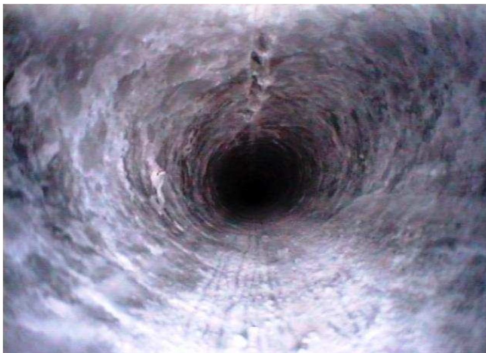
Foto 4g: Riss in der Firse bei 13,60 m
