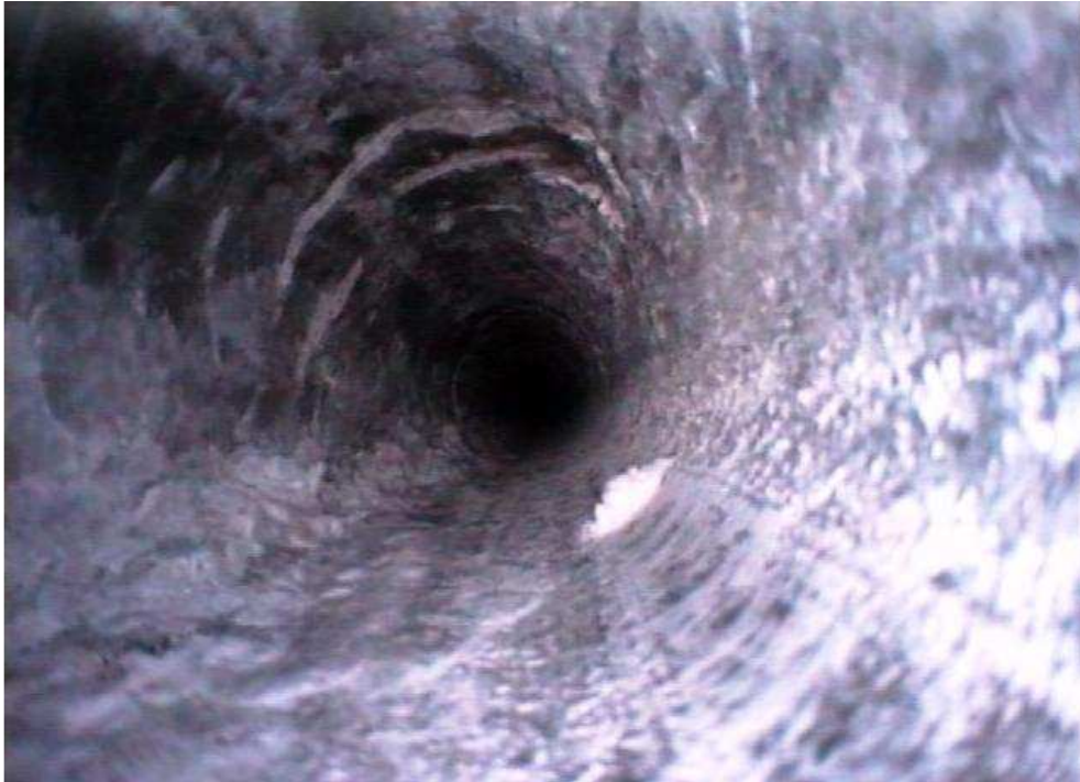
Foto 12e: Ausbruch Firste bei 45,00 m
