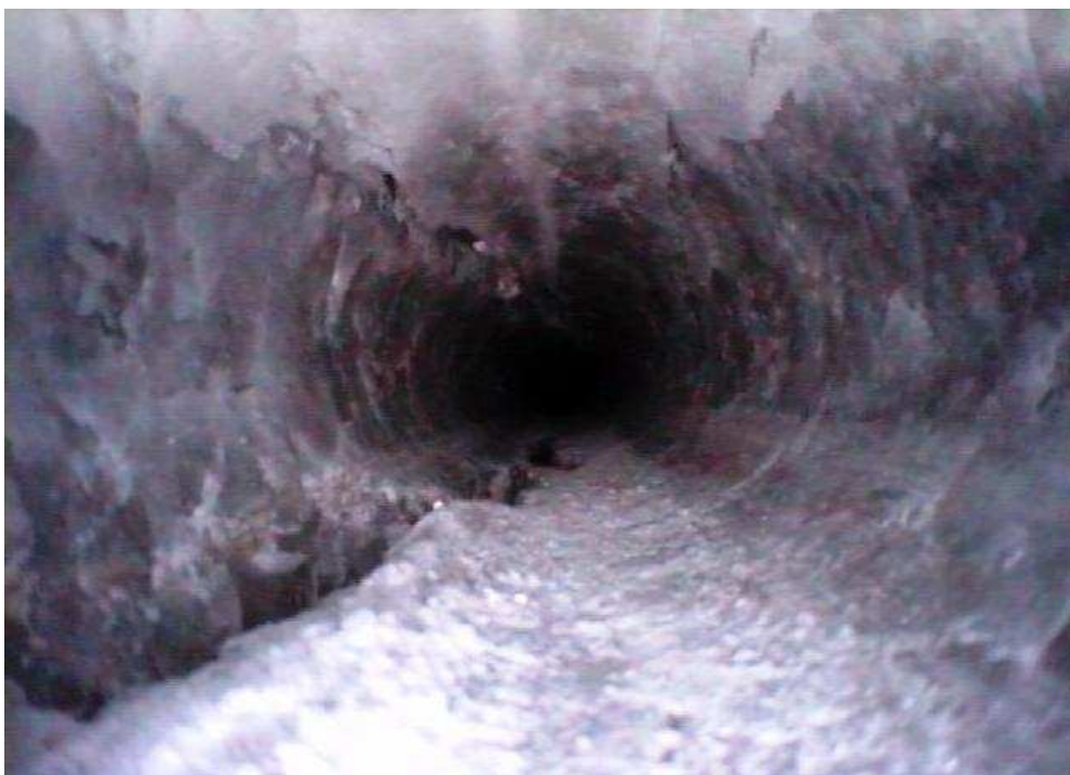
Foto 4b: Riss im Osten bei 9,70 m
