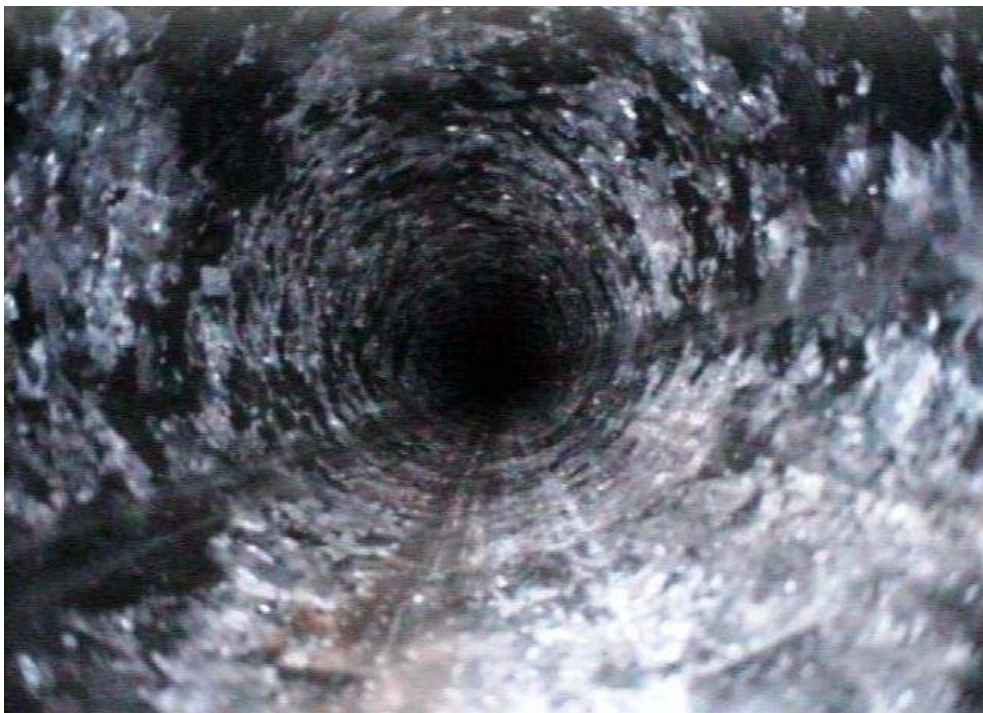
Foto 11d: Bohrloch feucht bei 23,30 m
