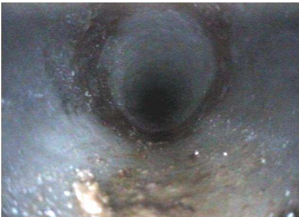
Foto 2b: Grenze K2C/Na 3 bei 1,00 m, Bohrloch feucht
