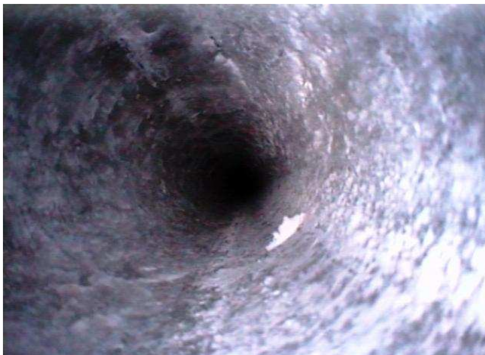
Foto 12c: Riss in der Firste bei 39,90 m, neu
