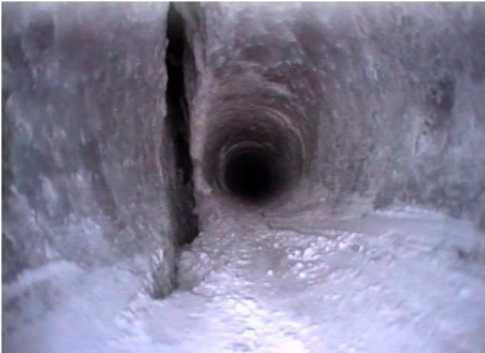
Foto 6g: Riss/Kluft im Osten bei 29,40 m
