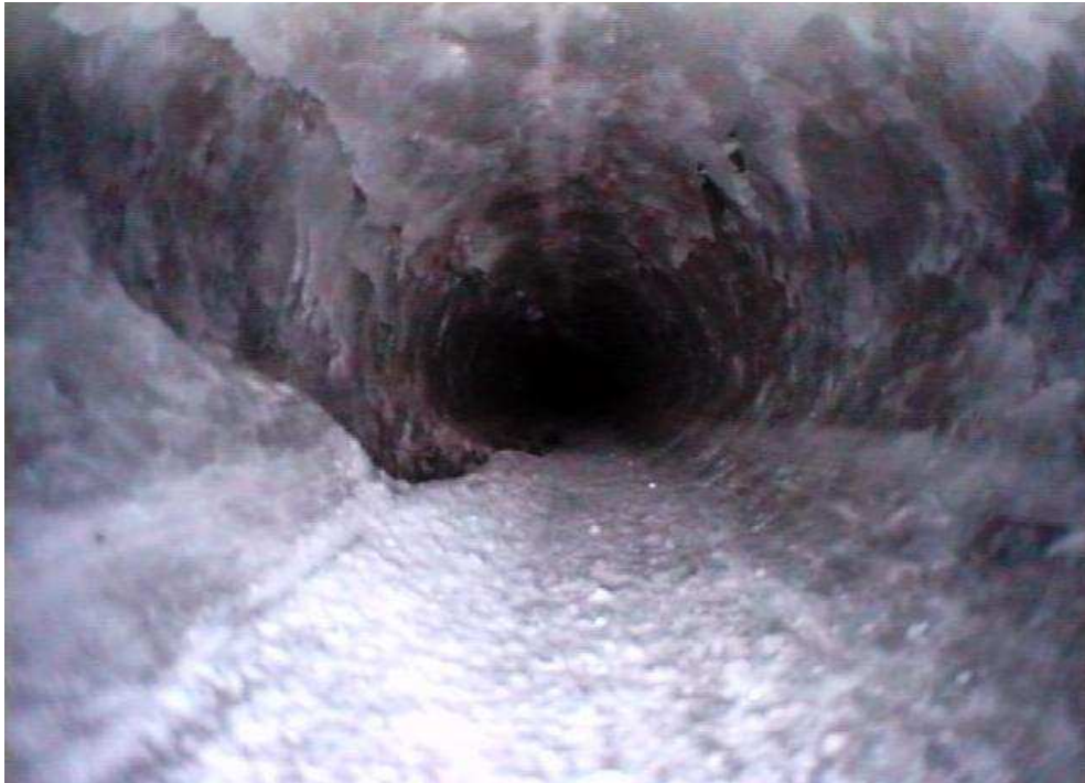
Foto 4a: Riss, Ausbruch bei 9,60 m
