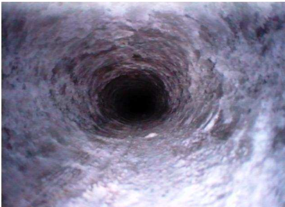
Foto 11b: Riss in der Sohle bei 17,30 m nicht sichtbar, Ausblühungen in der Sohle
