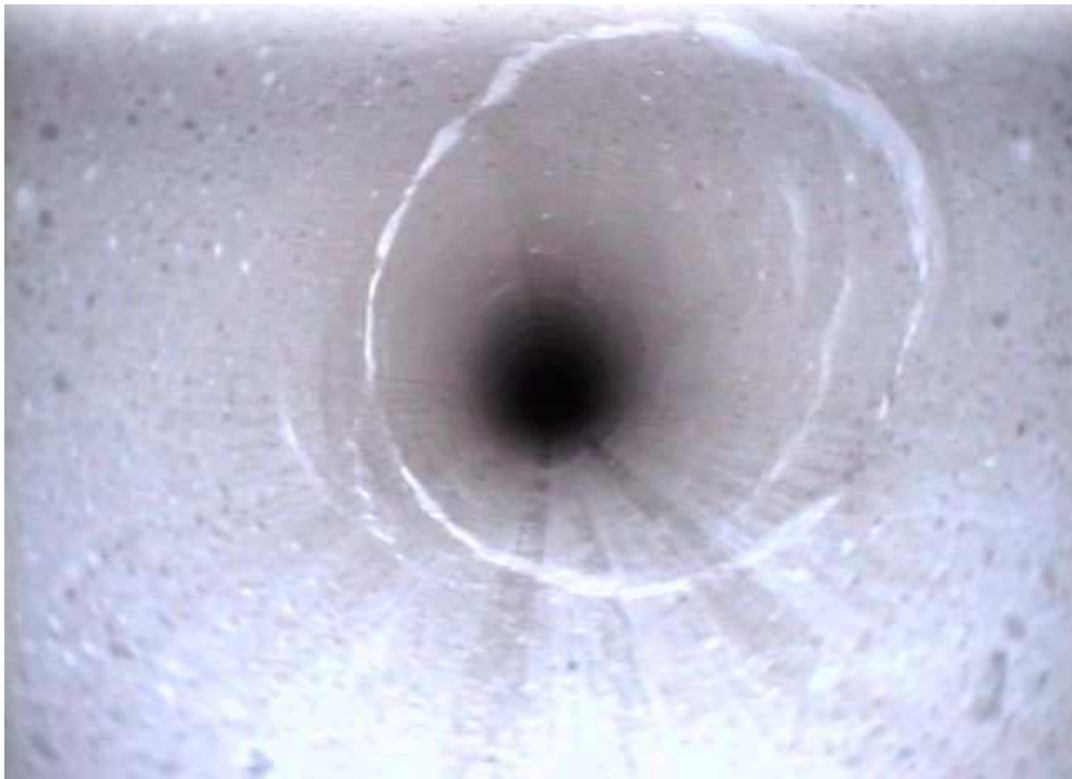
Foto 3e: Riss bei 30,60 m, neu
