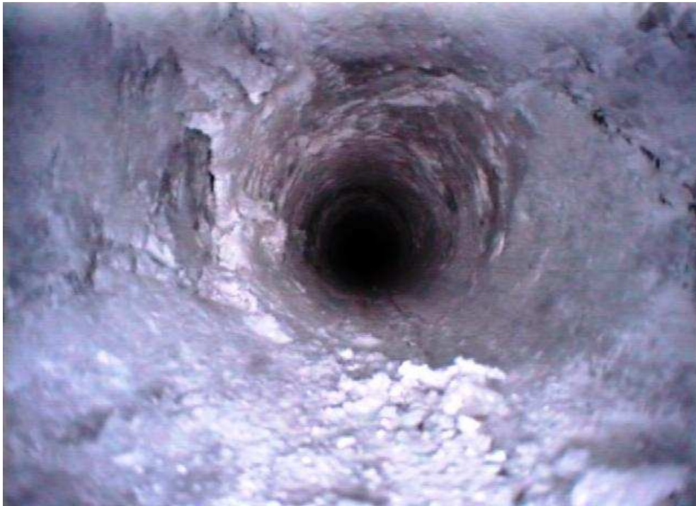
Foto 6e: Ausbruch und Risse bei 27,25 m
