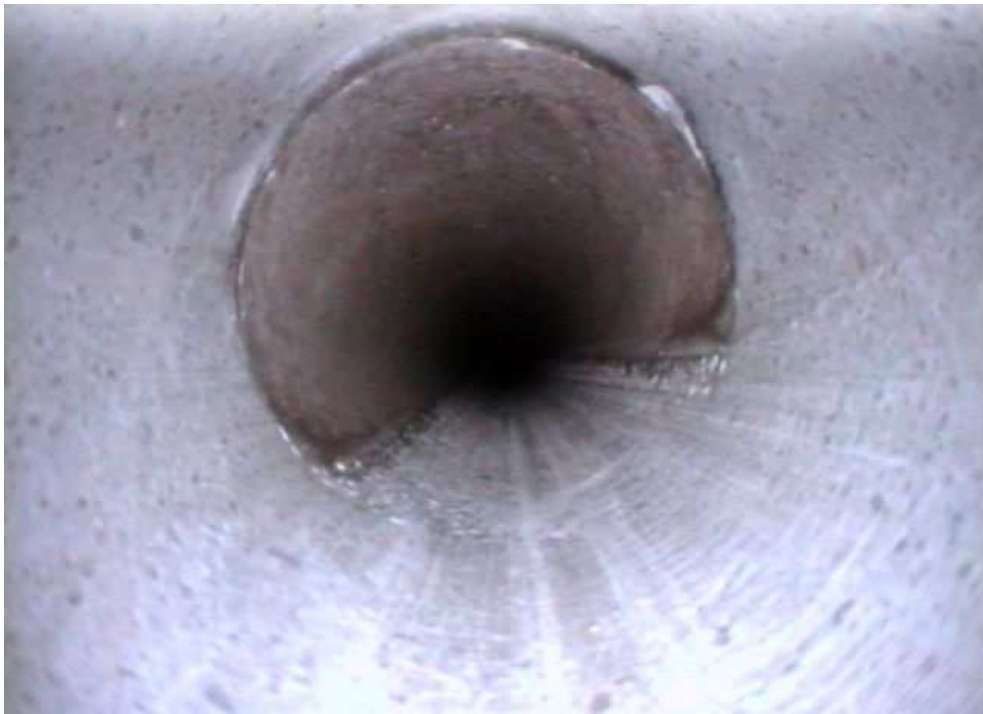
Foto 3c: Anfang Mauer bei 10,75 m
