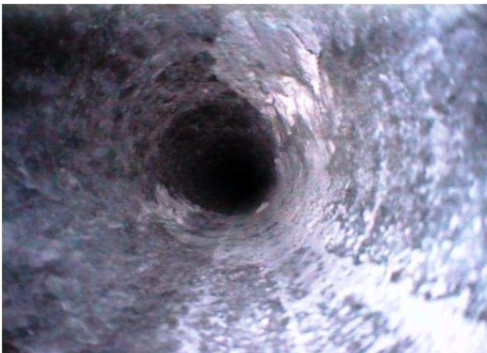
Foto 12b: Ausbruch bei 38,55 m
