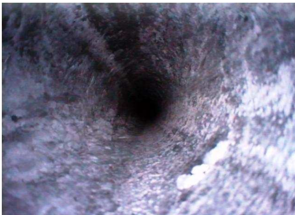
Foto 12d: Ausbruch bei 44,40 m
