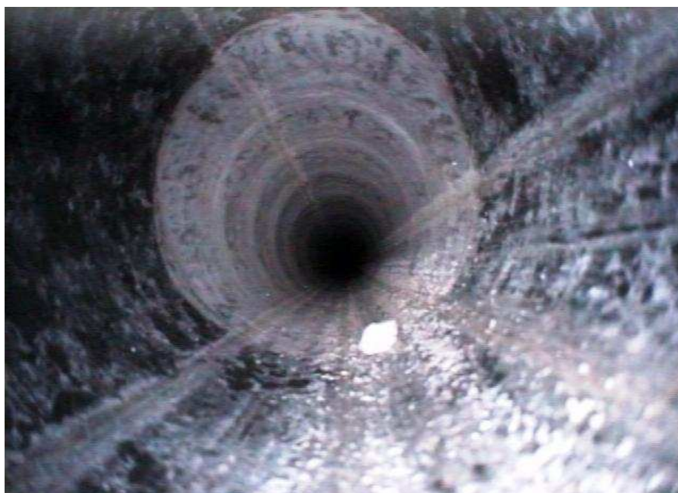
Foto 11f: Grenze feucht/trocken bei 27,80 m
