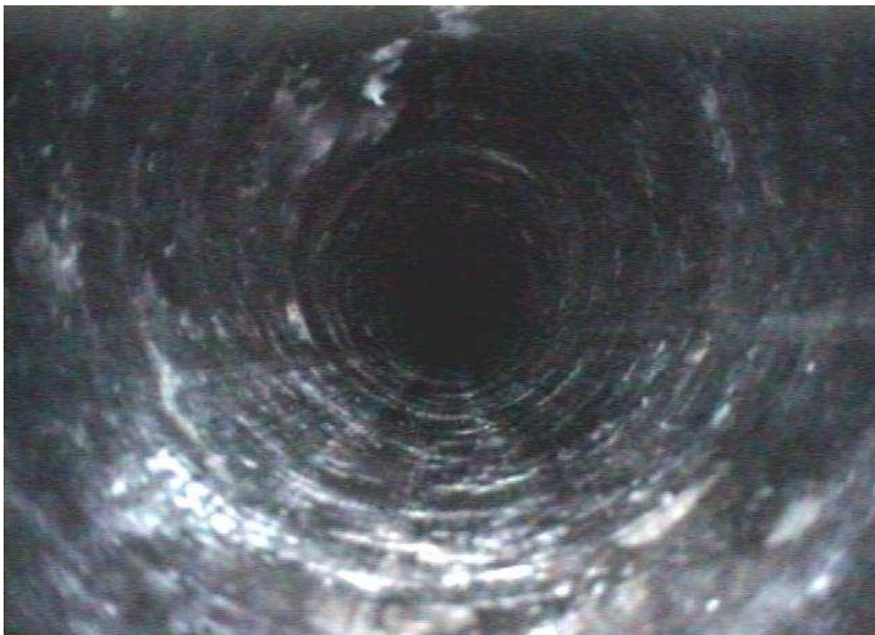
Foto 4j: Ausblühungen in der Firste bei 38,70 m, feucht
