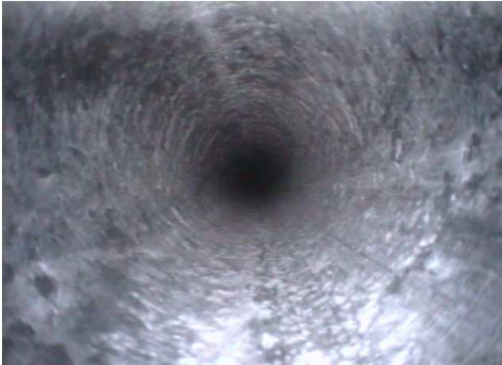
Foto 1a: Kleiner Riss im Westen bei 14,30 m
