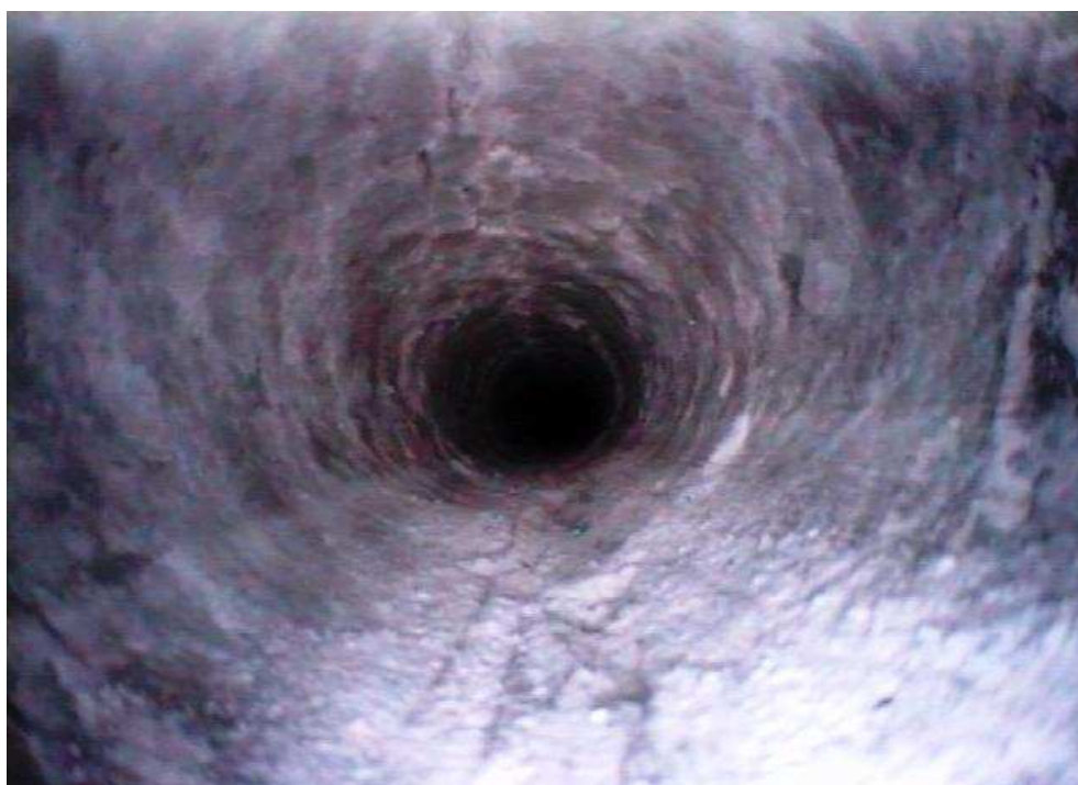
Foto 4h: Riss in der Firse und Sohle bei 14,00 m
