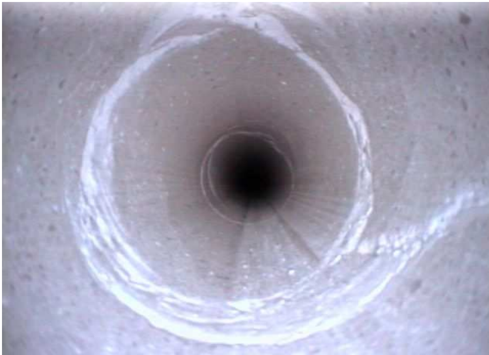
Foto 3g: Ausbruch/Riss bei 41,85 m
