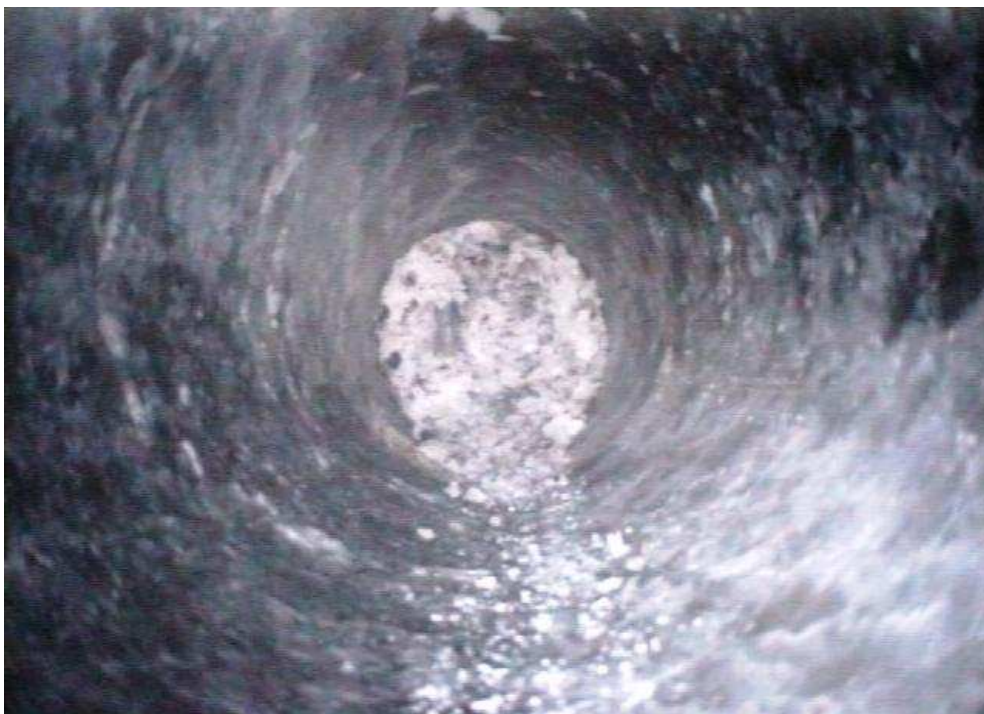
Foto 1d: Ausbruch in der Bohrlochsohle (trocken) von 57,90 m bis 57,99 m
