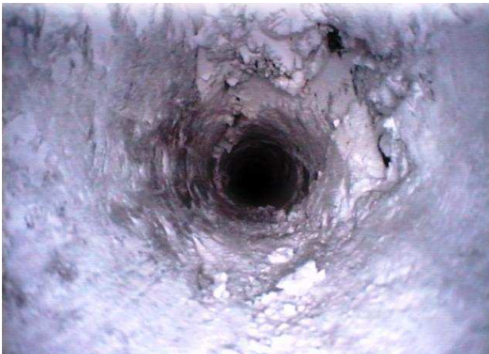
Foto 6d: Ausbruch und Risse bei 26,90 m
