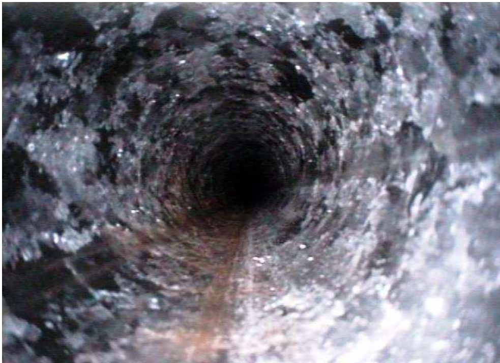
Foto 11c: Bohrloch feucht und braune Stellen bei 22,40 m
