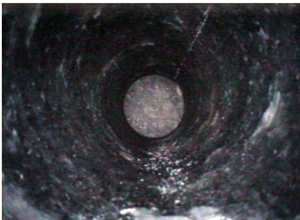
Foto 8b: Bohrlochende bei 44,62 m leicht feucht
