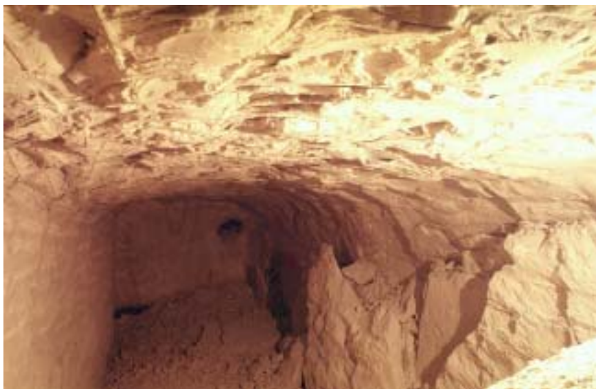
Foto 14: Abbau 7, 725-m-Sohle Na2, Schalenbildung am Stoß
