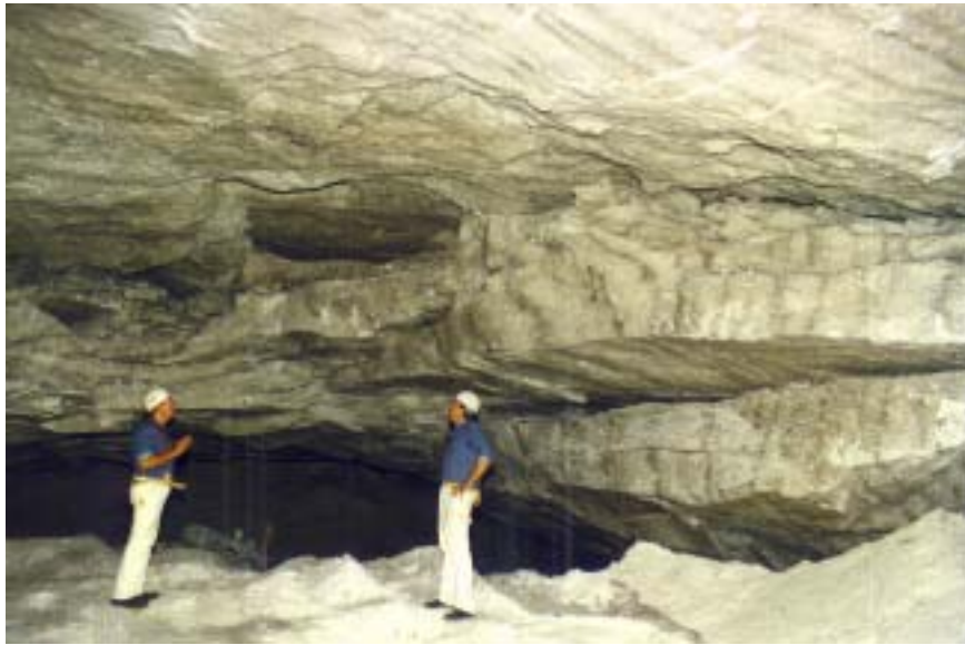
Foto 15: Abbau 7, 700-m-Sohle Schalenbildung in der Firste
