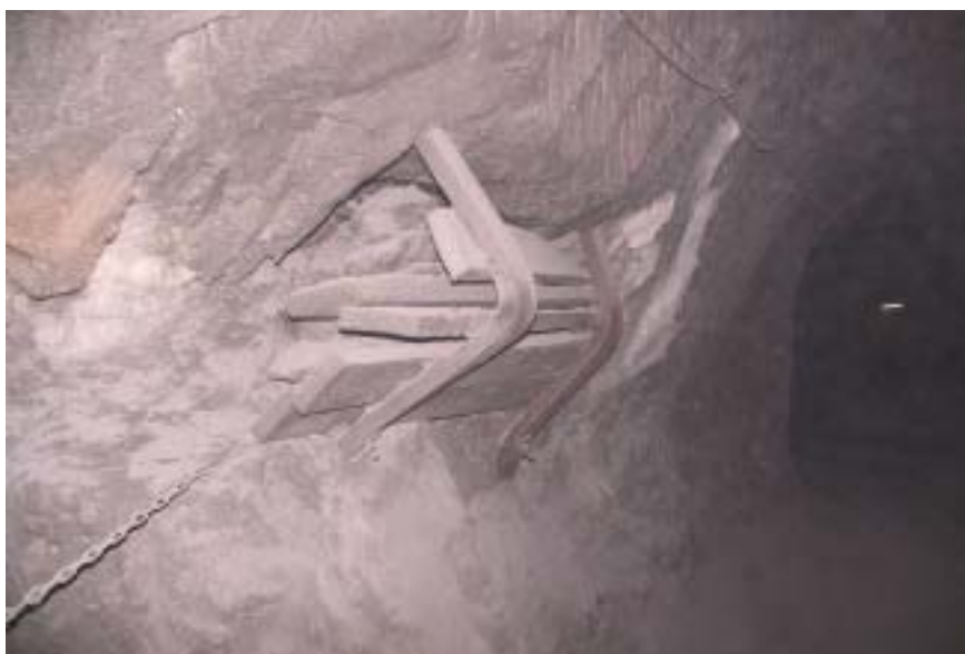
Foto 17: 750-m-Sohle, Konvergenz eines Rol- loches
