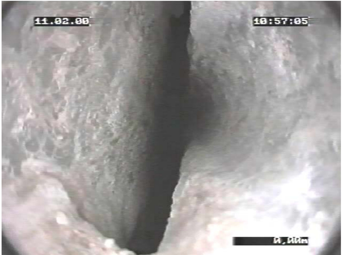
Bild 6: Typischer Riss in den Pfeilerkernen der Südflanke (Breite ca. 8 cm), Foto mit Bohrlochkamera aus dem Jahr 2000
