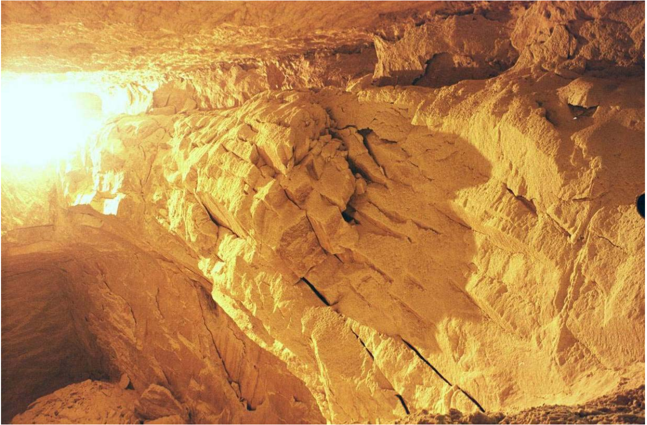
Bild 5: Reste der gebrochenen Schwebe zwischen den Sohlen 490 m und 511 m in der Abbaureihe 7 der Südflanke, Foto aus dem Jahr 2003
